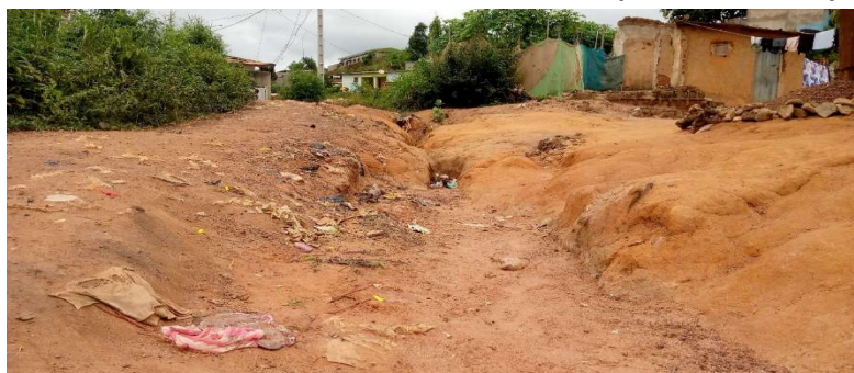
Photo 3 : Une route non bitumée fortement ravinée au quartier Kennedy extension 2
